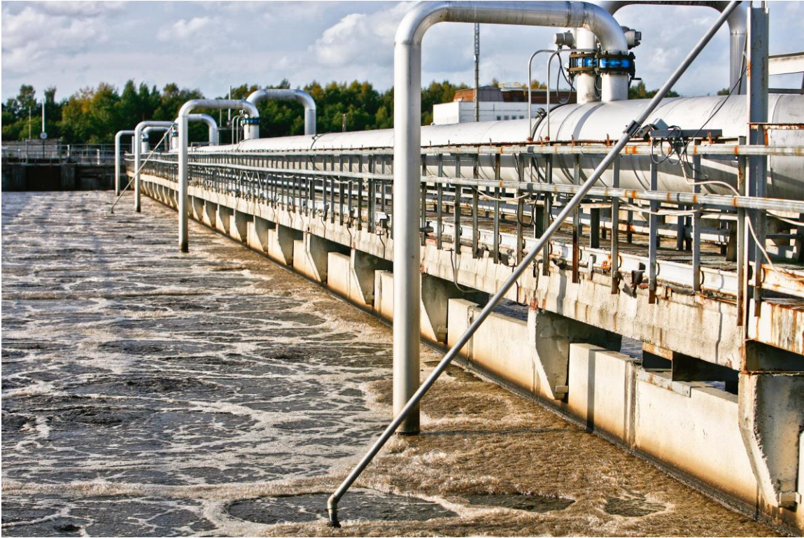
1.3. attēls. Notekūdeņu attīrīšana Daugavgrīvas NAI (foto F64).
