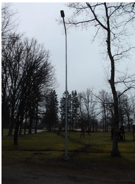
30. attēls. Ierīkots ielu apgaismojuma pagasta centrā
